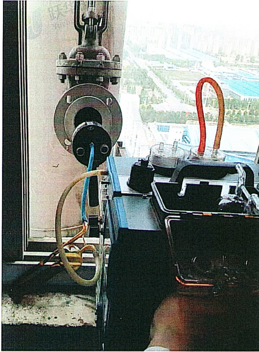
S4701 尿素放空管出口◎1
