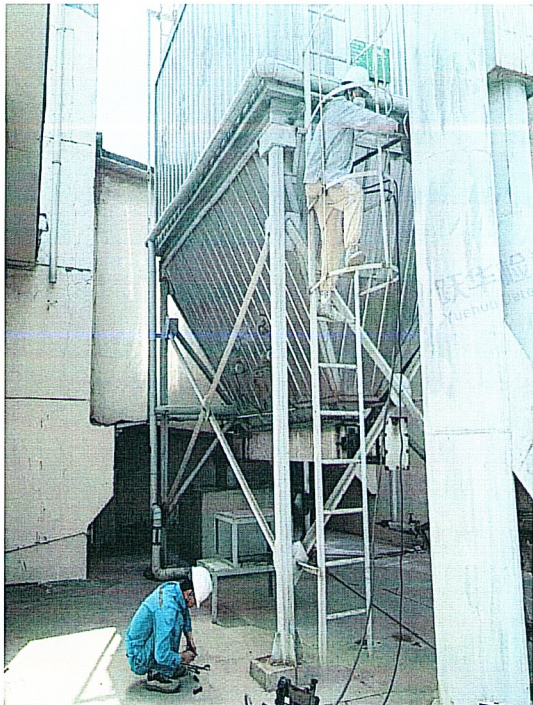
尿素造粒底部 C1#转运楼出口除尘器出口◎3
